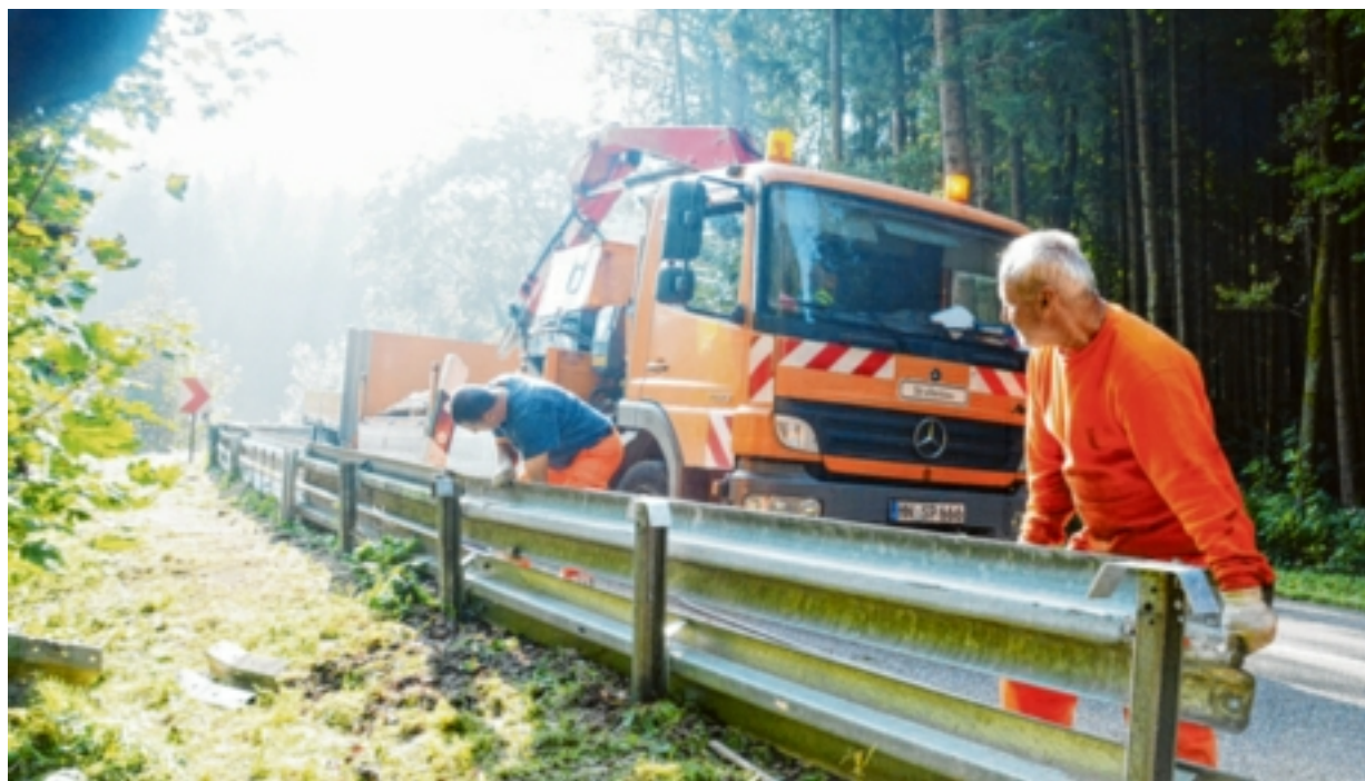
Hunderte Meter zusätzliche Leitplanken mussten aus Sicherheitsgründen für das Bergrennen montiert werden. Doch diese Maßnahme war nur eine von vielen Arbeiten, die notwendig sind, um die Boliden auf die Strecke schicken zu dürfen.
